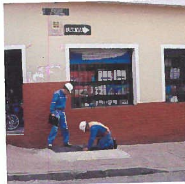
Cámaras bajo el piso
