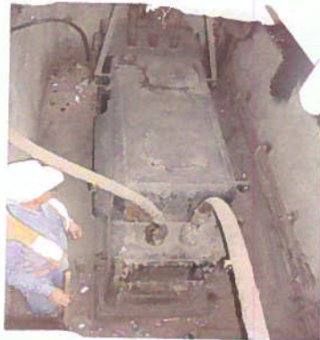
Gráfico 6. Transformador de distribución
