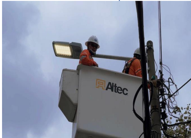
Ilustración 4. Cambio de luminarias de vapor de sodio a Tecnología LED
