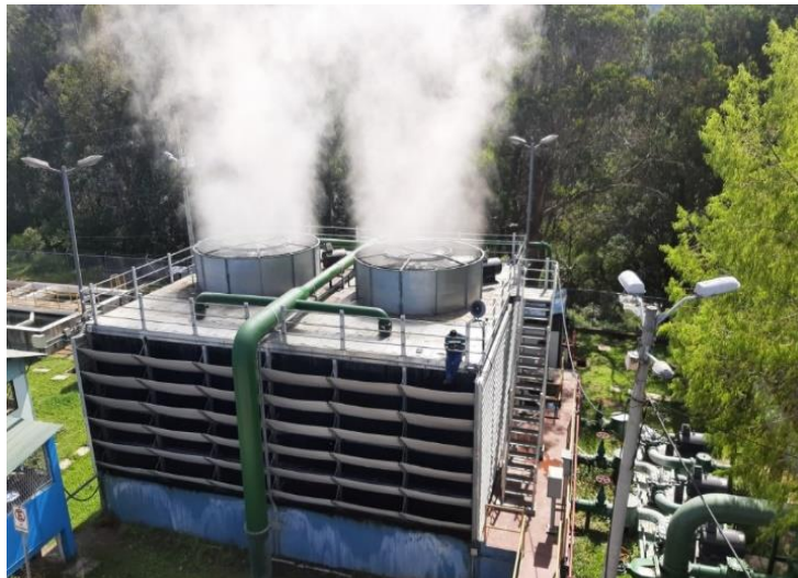
Ilustración 12. Torre de enfriamiento
