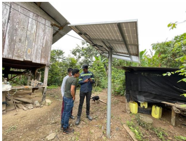
Ilustración 9. Electrificación Rural con Sistemas Fotovoltaicos Aislados
