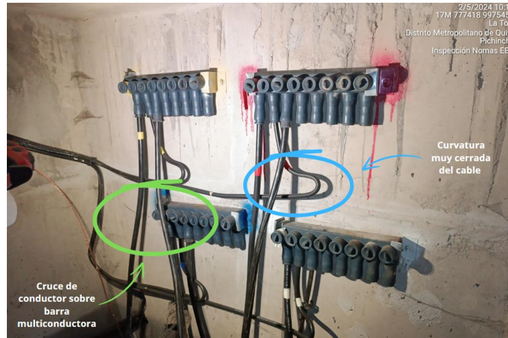
Fig. A-15.09_ 8 Incorrecta instalación de barras multiconductoras.
