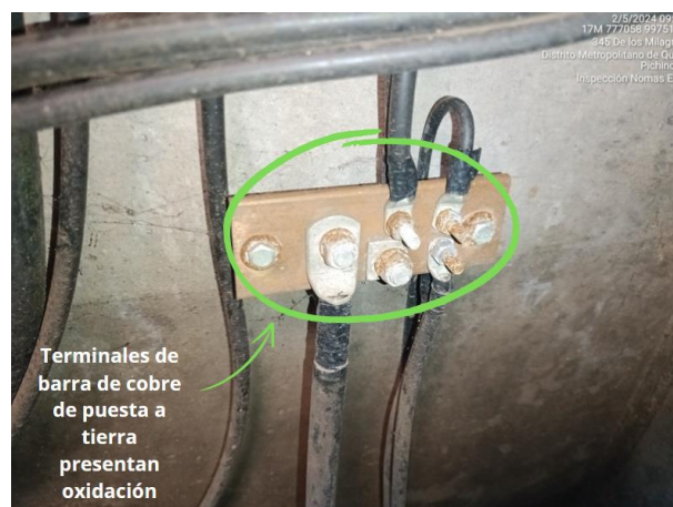
Fig. A-15.09_ 9 Terminales de barra de cobre de puesta a tierra con oxidación.
